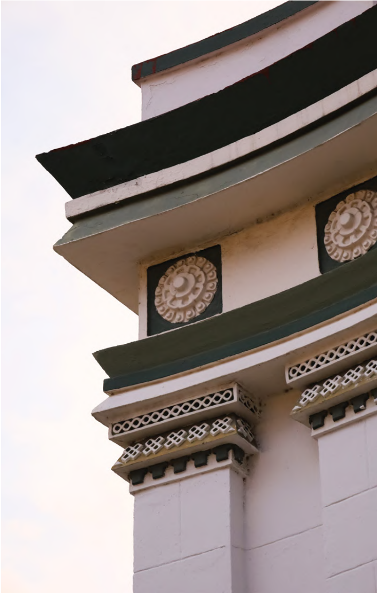
FIGURA 9. Detalle de la fachada del Sanatorio Rendón Peniche (1919) en Mérida (Yucatán). Fotografía: Paulo Peña.
